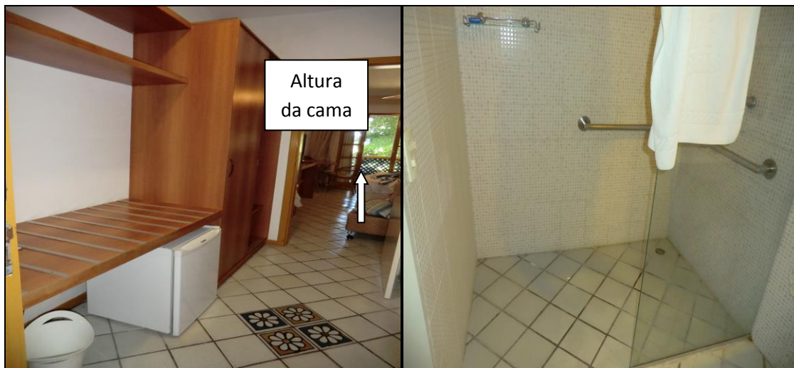
Figura 9 – Banheiro da Uh sem cadeira de banho
